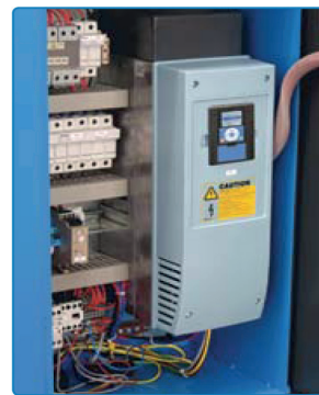
Panneau électrique et onduleur
