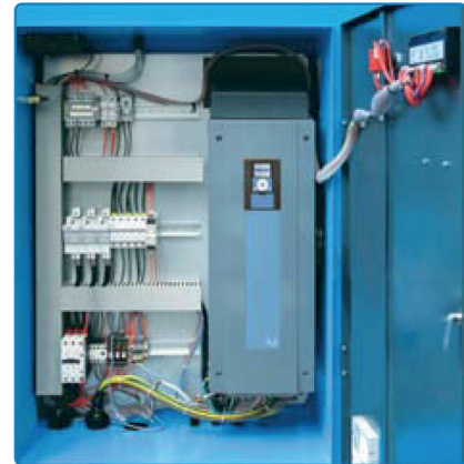
Panneau électrique et onduleur
